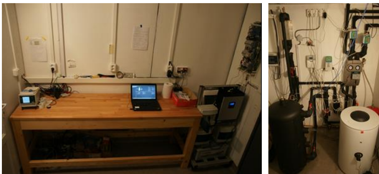
Obrázek 3 Technologická místnost s měřicí ústřednou (vlevo) a střídačem pro FV část (vpravo)
